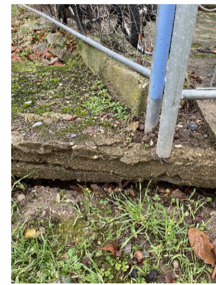
3.5 Übergang / Zugang Innenhof Bodenplatte unterspült
