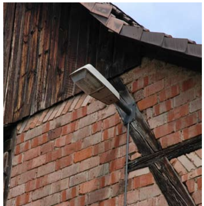
Straßenleuchte im Saulauf, Bestand
